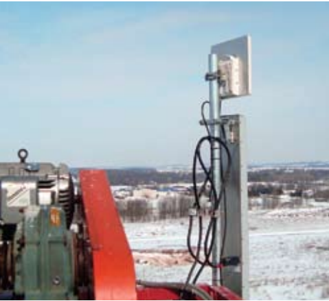
WiMAX backhaul, USA
